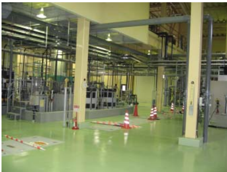
写真6 浸出水処理施設内の様子
