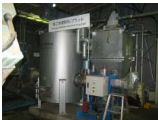
写真 6-11 東京農大式生ごみ堆肥化プラント 大学内のごみ集積場に隣接しているプラント。
